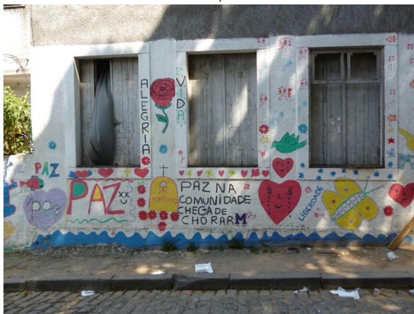
Fotografia 17: Casa ameaçada na Ladeira do Barroso em função da construção do teleférico e de um prédio para moradia popular (fev. 2012)
