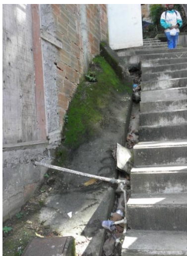
Figura 41 – Escadaria reformada (íngreme); precariedade da infraestrutura.
