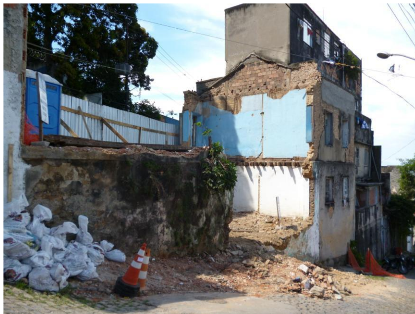
Fotografia 18: Fachada dos fundos de casa na Ladeira do Barroso e demolição de casa vizinha (fev.2012)
